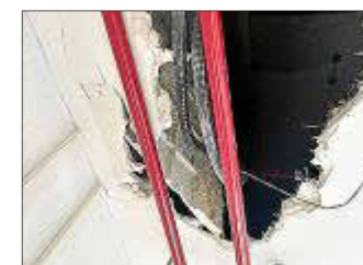
La zona afectada.
