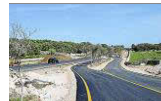
Zona de las obras afectada.
