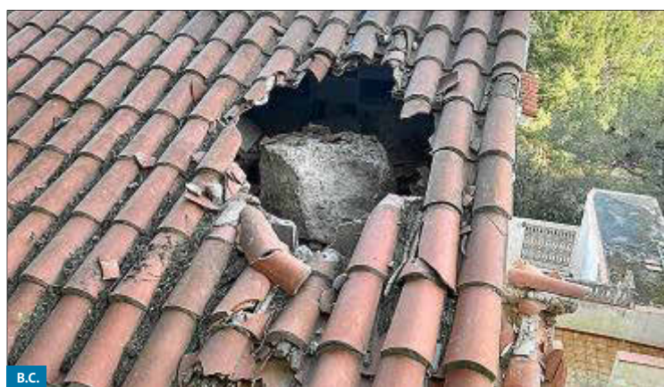
La roca causó un importante agujero en la vivienda.
