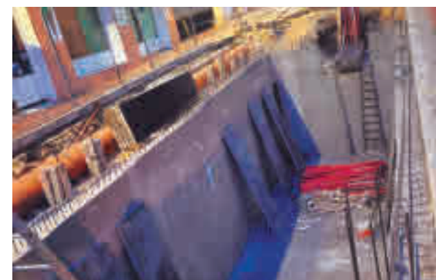
DEPÓSITO DE TORMENTAS - ES CASTELL
